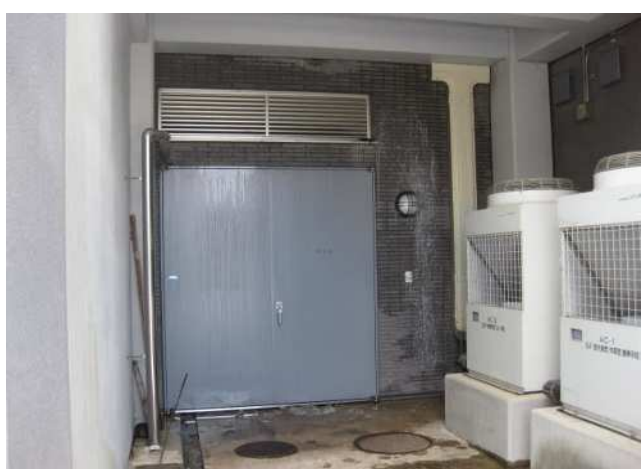
部位:外壁 仕様:落雪及び雪溶け水の処理 劣化状況:機械室扉を開けると雪溶け水が浸入する 特記事項:機械室(2)外部扉の雨仕舞
