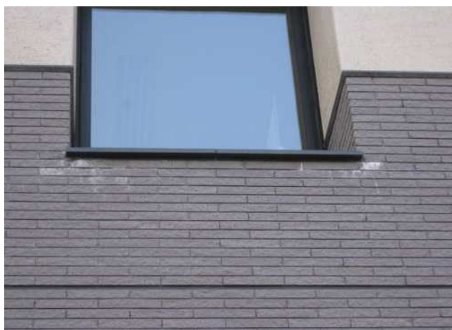
部位:外壁 仕様:タイル張り 劣化状況:白化現象がある 特記事項:範囲は小規模
