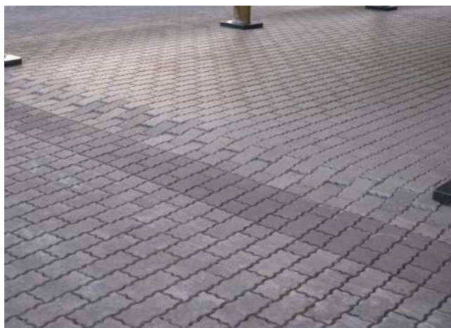
部位:外壁 仕様:外部床インターロッキング 劣化状況:床の凹凸による段差 特記事項:段差解消のストロークが短い
