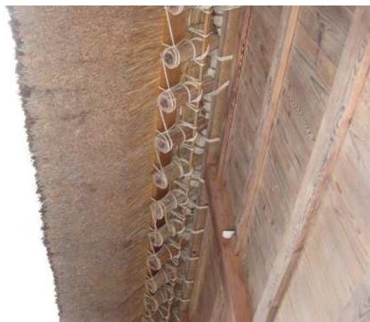
部位:屋根 屋上 仕様:茅葺き屋根 劣化状況:汚れている程度 特記事項:改修後10年以内
