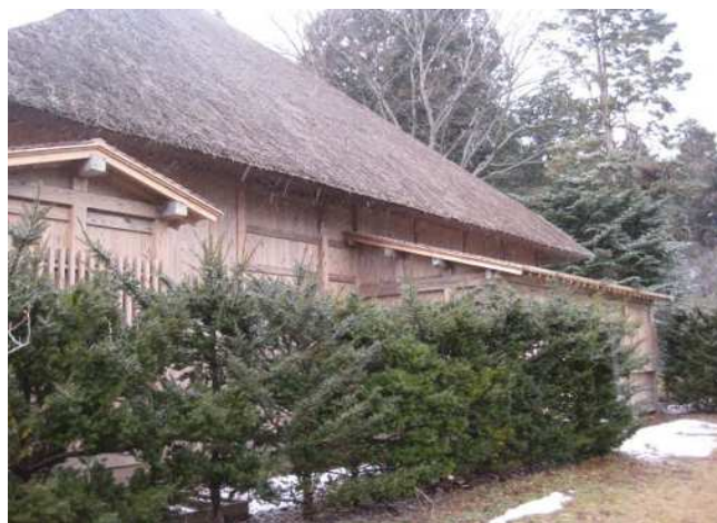
部位:外壁 仕様:杉板張り(相決り)、貫 赤松 劣化状況:特になし 特記事項:改修後10年以内
