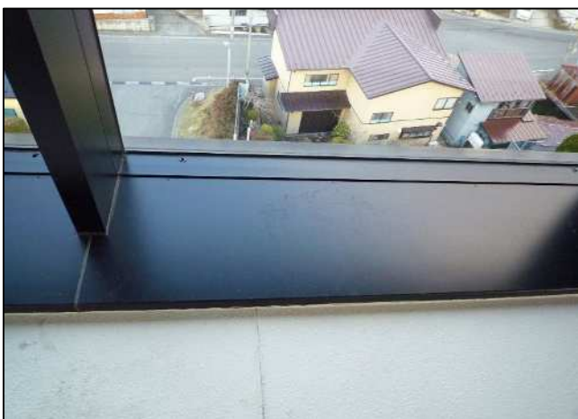
部位:外壁 仕様:カーテンウォール 劣化状況:展望タワー窓廻りで漏水が 特記事項:小規模ではあるが強風を伴った降雨時に発生
