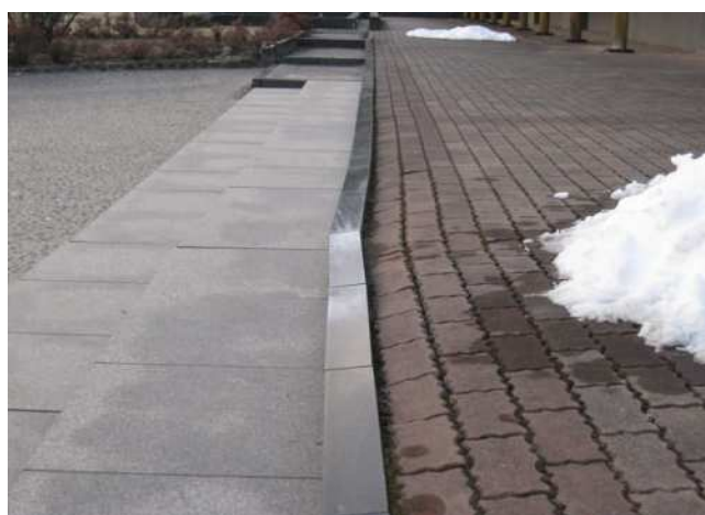
部位:外壁 仕様:外部床インターロッキング 劣化状況:床段差部分の傾斜 特記事項:段差解消のストロークが短い
