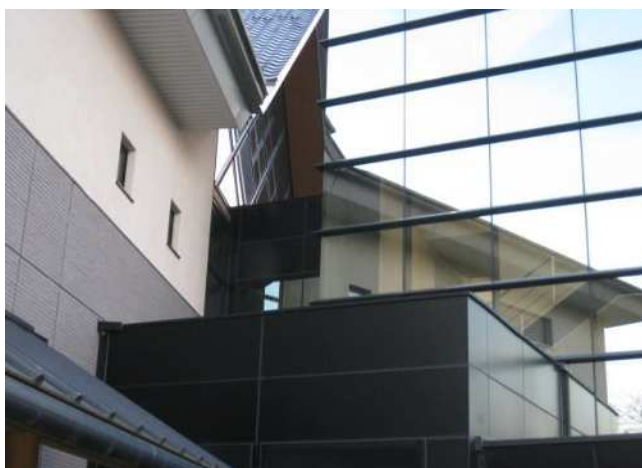
部位:外壁 仕様:軽量骨材吹付 劣化状況:汚れている程度 特記事項:渡り廊下天井で強風時に雨漏り
