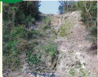
被災直後 平成27年8月
