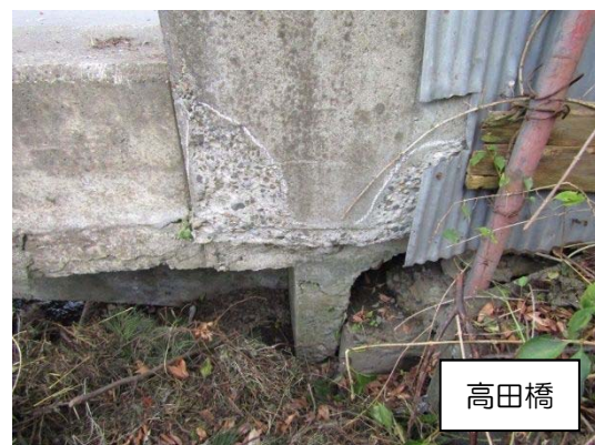
写真6 下部工の損傷
