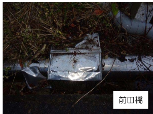
写真4 添架物の損傷
