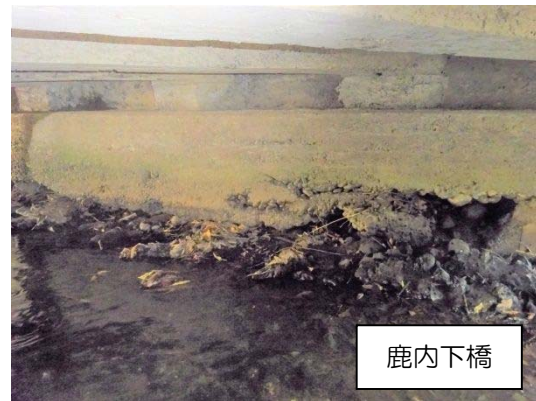
写真2 下部工の損傷
