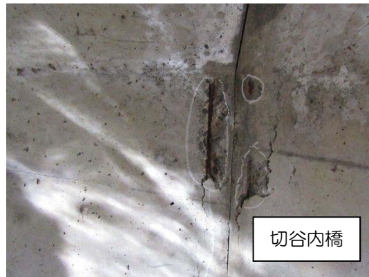
写真 10 下部工の損傷
