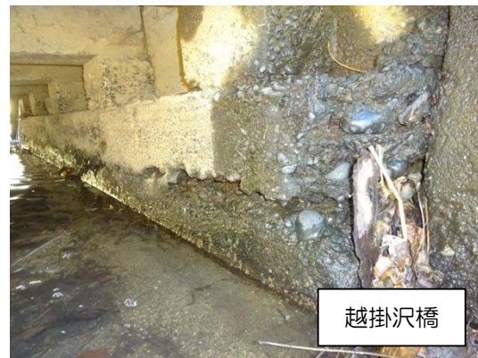
写真4 下部工の損傷
