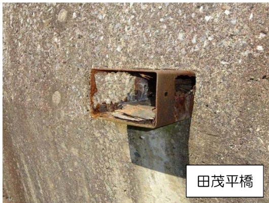
写真1 排水管の損傷
