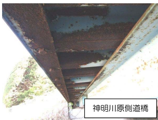
写真1 鋼床版の損傷
