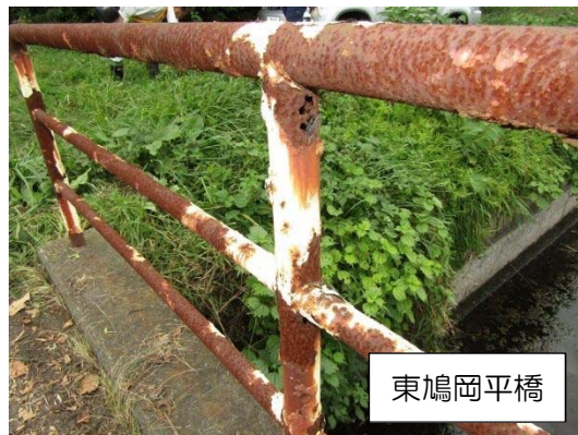
写真5 防護柵の損傷
