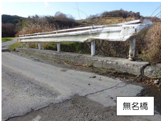
写真3 防護柵の損傷
