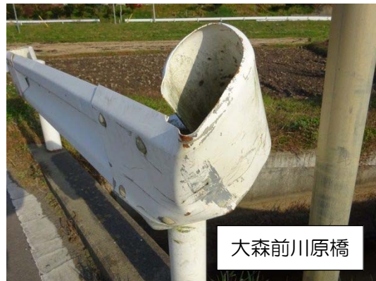
写真2 防護柵の損傷
