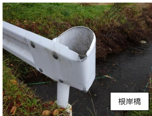
写真2 防護柵の損傷
