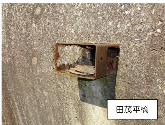
写真1 排水管の損傷
