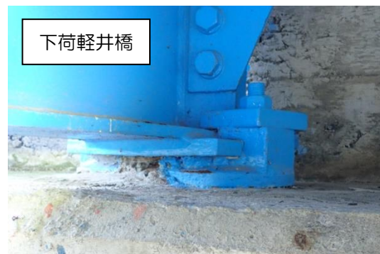
写真2 沓座モルタルの損傷
