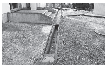
倉石中学校の要望の一つ 校舎裏の側溝修繕
