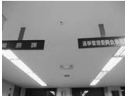
左側 蛍光灯 右側 LED照明
