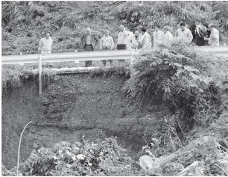
路肩と法面が崩れた小渡線(苗代沢地区)
