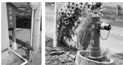
濁りの原因となった消火栓
