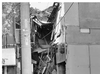
半壊となっているが、対応が困難な家屋
