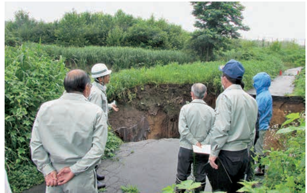
② 町道小渡鳥沼線の道路流出現場 被災延長 L=15.0m 盛土・法面工
