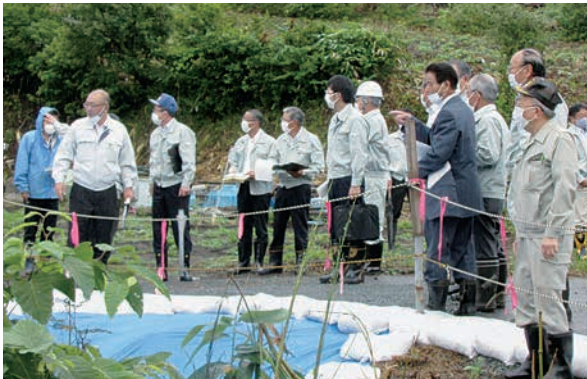
① 檜沢地区の道路の路肩崩落現場 被災延長 L=16.0m 盛土・法面工
