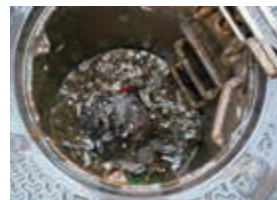
家庭ごみのつまったマンホール内部
