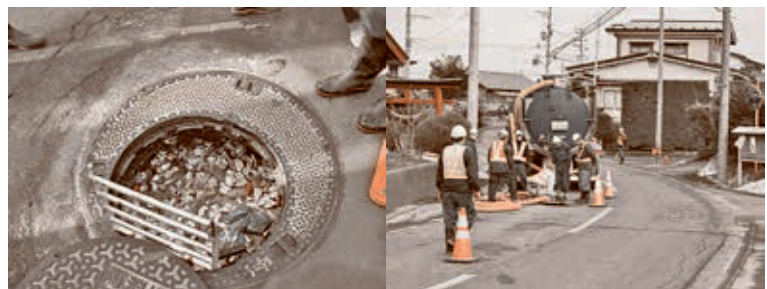
発泡スチロール容器等 家庭ごみの詰まったマンホール内部
