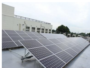
【太陽光発電設備】
