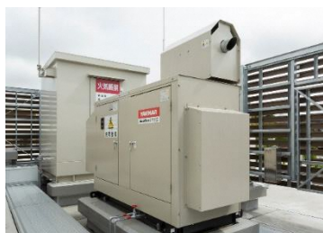
【自家発電設備】
